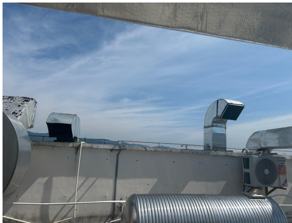
图 2-3 项目注液、烘烤、抽真空有机废气排口现状图
